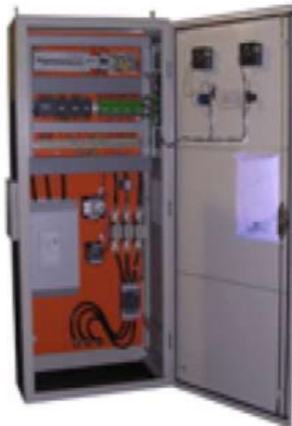
Painel de Comando
