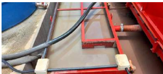
Imagens do sistema de lavagem de rodas automático.
