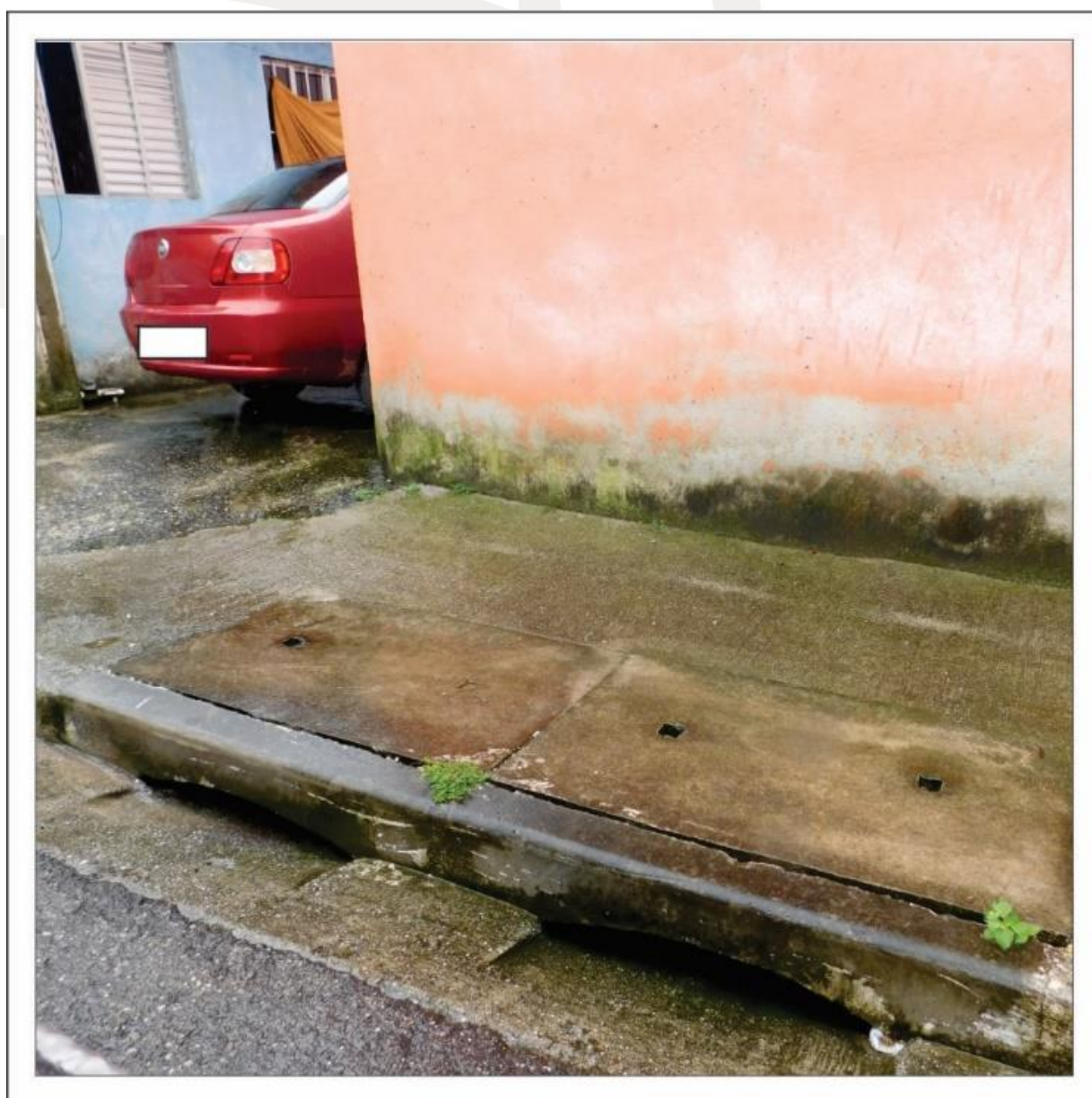
Figura 32. Fotografias - Boca de lobo da via de acesso ao empreendimento. Elaborado por Global Vias.
