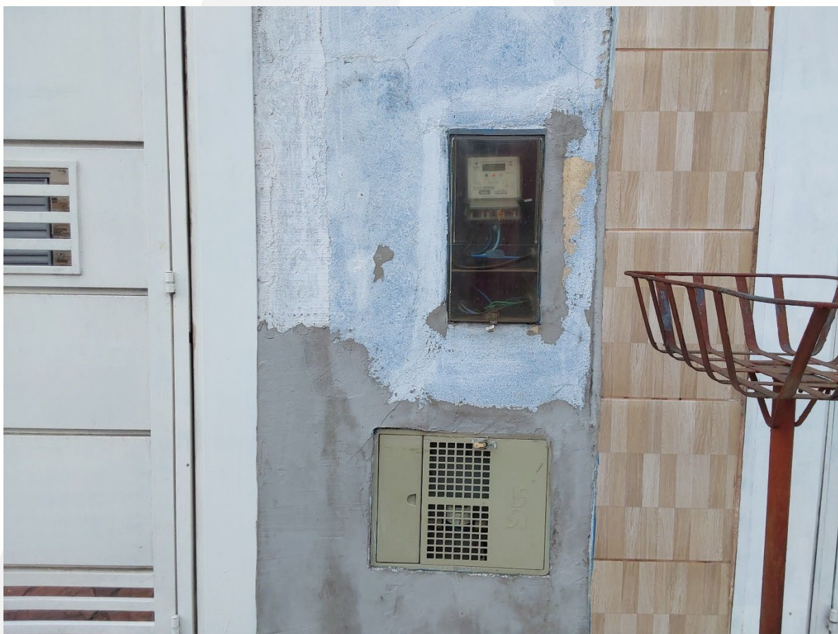
Figura 11 – Relógio de medição de água e energia.
