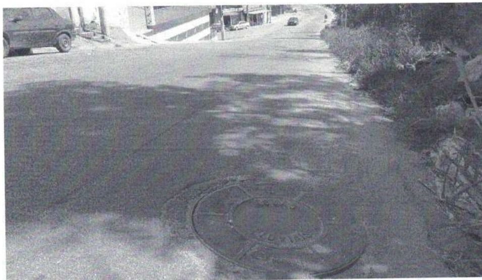
Figura 51: Foto do sistema de Drenagem existente (águas pluviais) Fonte: Ambientium (2018)
