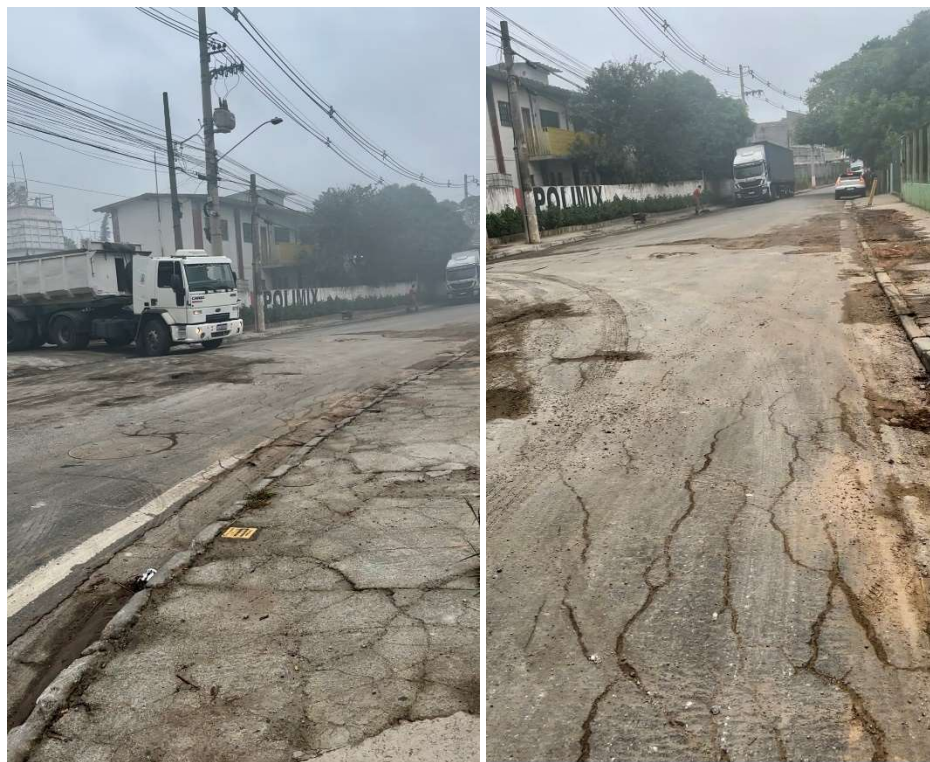
Fotos 1 e 2: trânsito pesado na via objeto de estudo, cuja pavimentação apresenta avarias consideráveis (vista sentido bairro)
