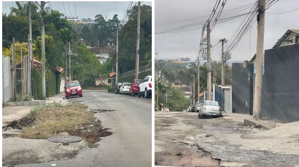
Fotos 7 e 8: Rua Ernesto Joaquim de Souza, pavimentação extremamente prejudicada pelo alto tráfego de caminhões pesados.
