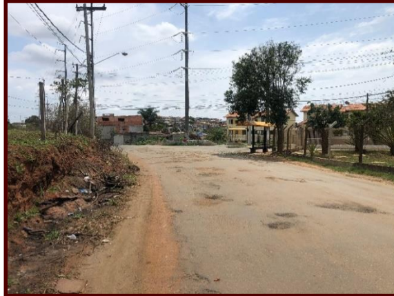
Figura 4.14 – Acesso ruim, sem pavimentação adequada. Estrada José Conceição.
